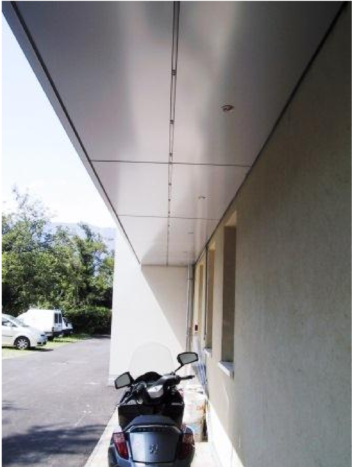
Vista pensilina lato Ovest. L'illuminazione esterna è stata integrata con il montaggio nella pensilina di faretti incassati a LED, capaci di lunga durata e bassissimo consumo.
