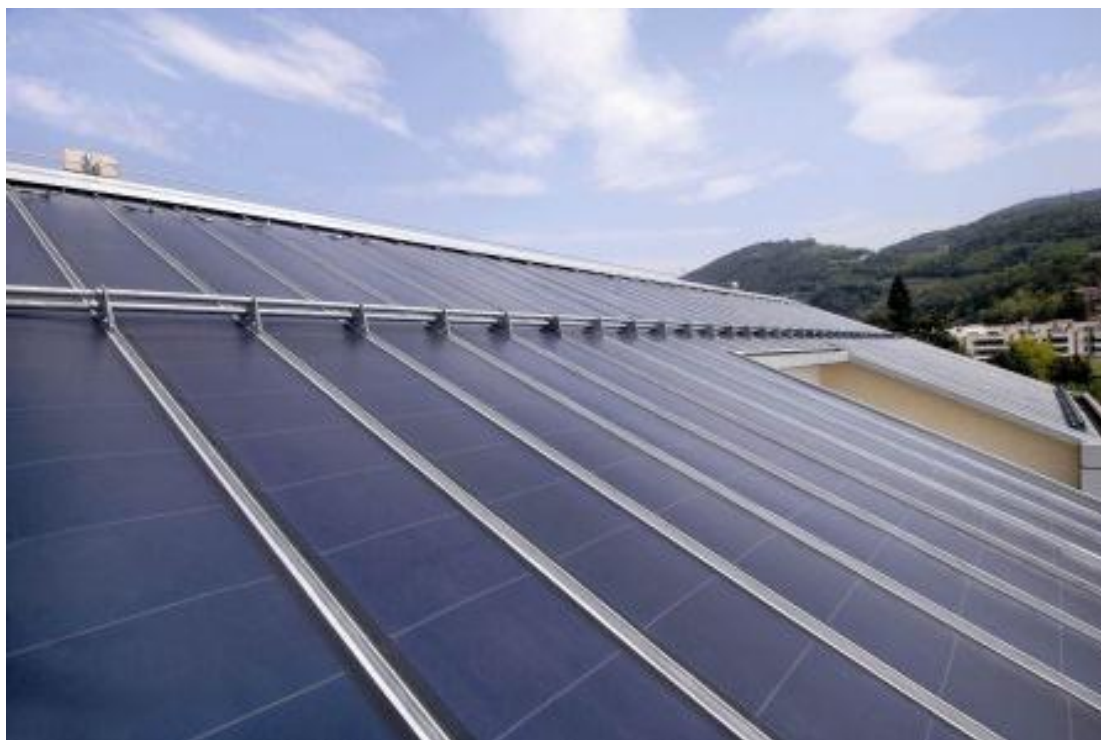
Foto della copertura sud della sede CET: l'impianto fotovoltaico è perfettamente integrato nella struttura edilizia. Si possono notare anche i paraneve e sul colmo il sistema anticaduta fisso predisposto per gli interventi di ispezione e manutenzione.
